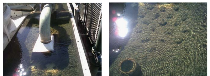
รูปที่ 8 ถาดน้ำด้านบนหอผึ่งเย็นเมื่อปริมาณโอโซนไม่เพียงพอ จะพบตะไคร่ในถาดบนอุดรูเป็นจำนวนมาก
